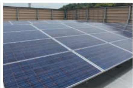
倉敷営業部 太陽光発電設備
