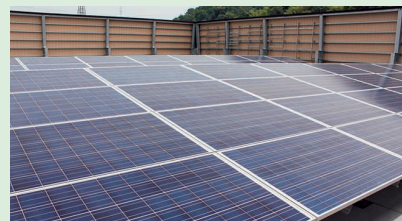
倉敷営業部 太陽光発電設備
