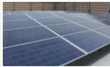
倉敷営業部 太陽光発電設備
