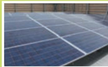
倉敷営業部 太陽光発電設備
