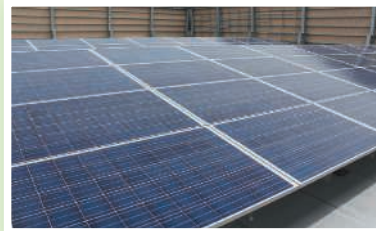
倉敷営業部 太陽光発電設備
