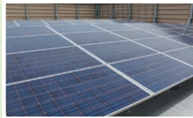
倉敷営業部 太陽光発電設備
