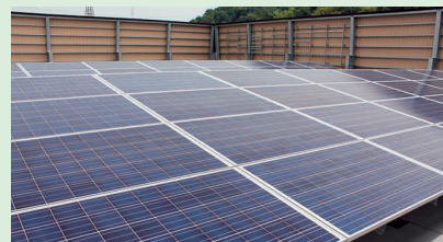
倉敷営業部 太陽光発電設備
