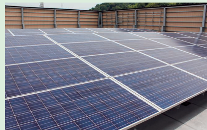
倉敷営業部 太陽光発電設備
