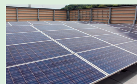
倉敷営業部 太陽光発電設備
