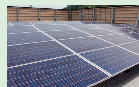
倉敷営業部 太陽光発電設備
