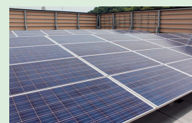
倉敷営業部 太陽光発電設備
